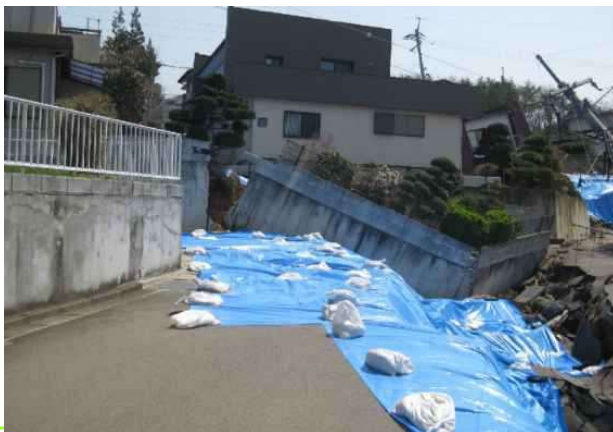
(c)腹付け盛土の崩壊の事例
