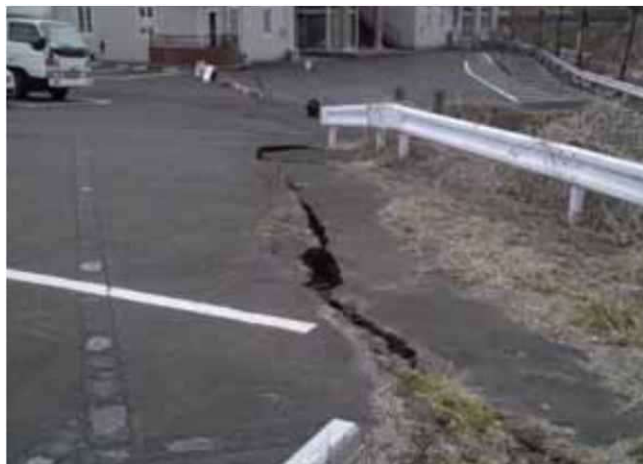
(b)のり肩の亀裂の事例
