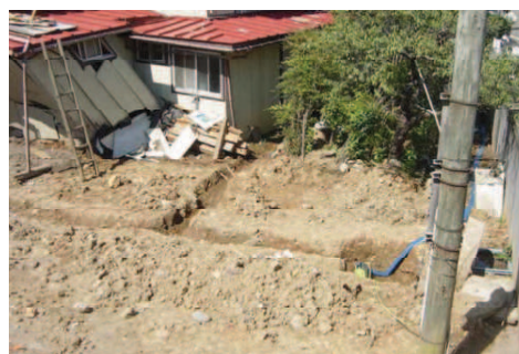
(b) 地震により湧水が出た箇所
