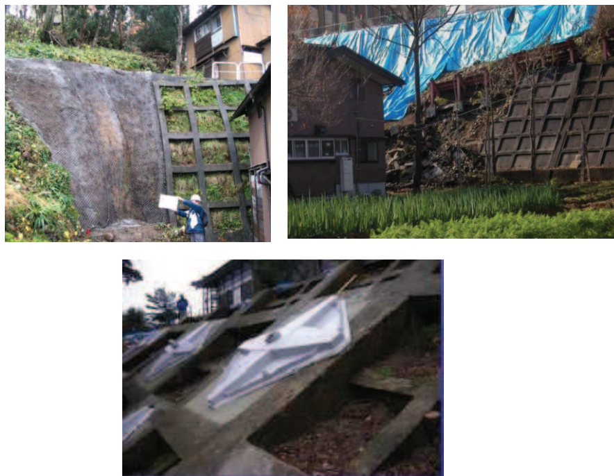
写 3-12 のり面保護工の変状の例
