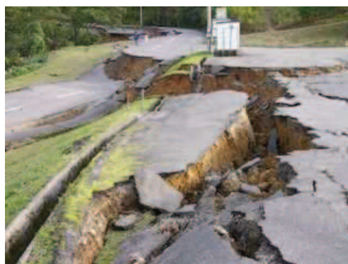
写 3-13 排水施設の変状の例
