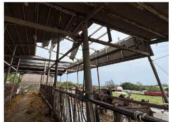
牛舎の屋根の破損（和泊町）
