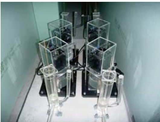
【水管傾斜計検出器（有村坑道内）】
