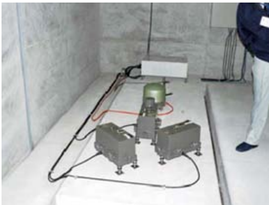
【地震計（有村坑道内）】
