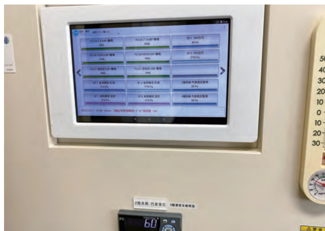
放射性防護設備の稼働訓練
