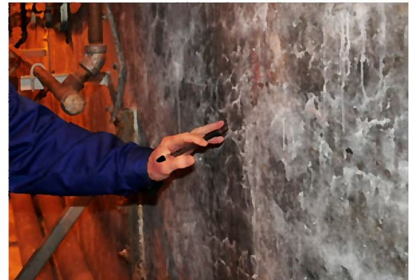
シーブルック1号におけるASRの発生状況※1
