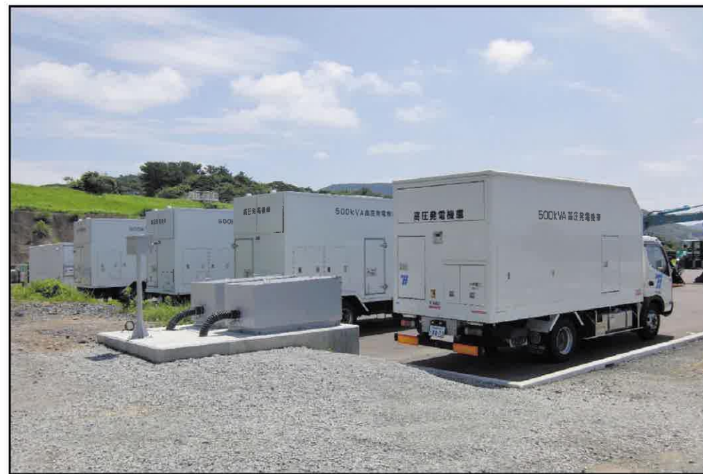
高圧発電機車
