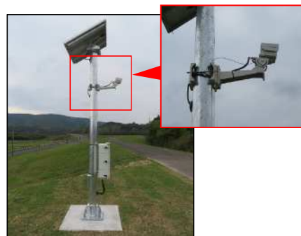
簡易型河川監視カメラ
