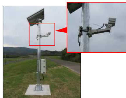
簡易型河川監視カメラ
