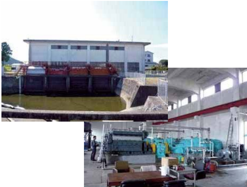
湛水防除事業 川内地区
