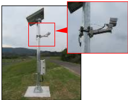
簡易型河川監視カメラ
