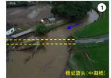
【被災状況写真】
