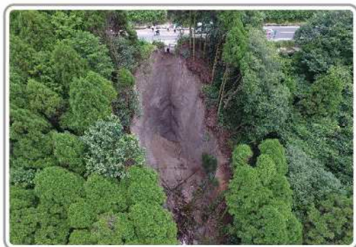
施設災害（農道法面崩落）
