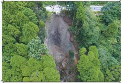
施設災害（農道法面崩落）
