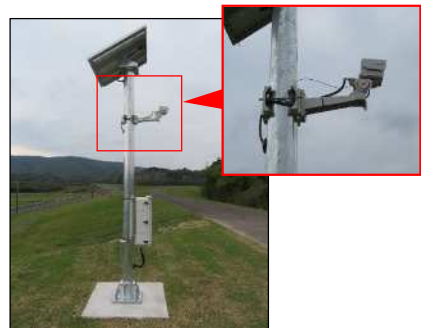
簡易型河川監視カメラ
