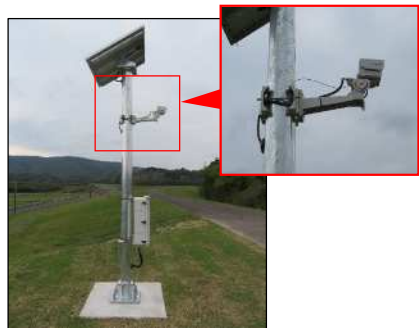
簡易型河川監視カメラ
