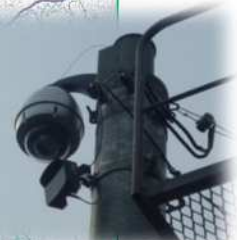
防災用監視カメラ
