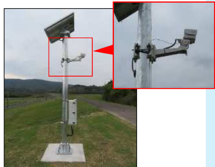
簡易型河川監視カメラ
