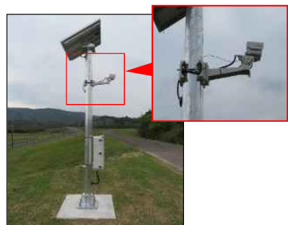
簡易型河川監視カメラ
