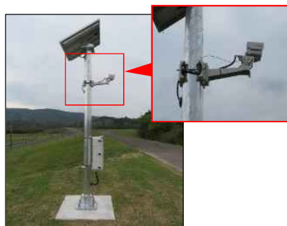
簡易型河川監視カメラ
