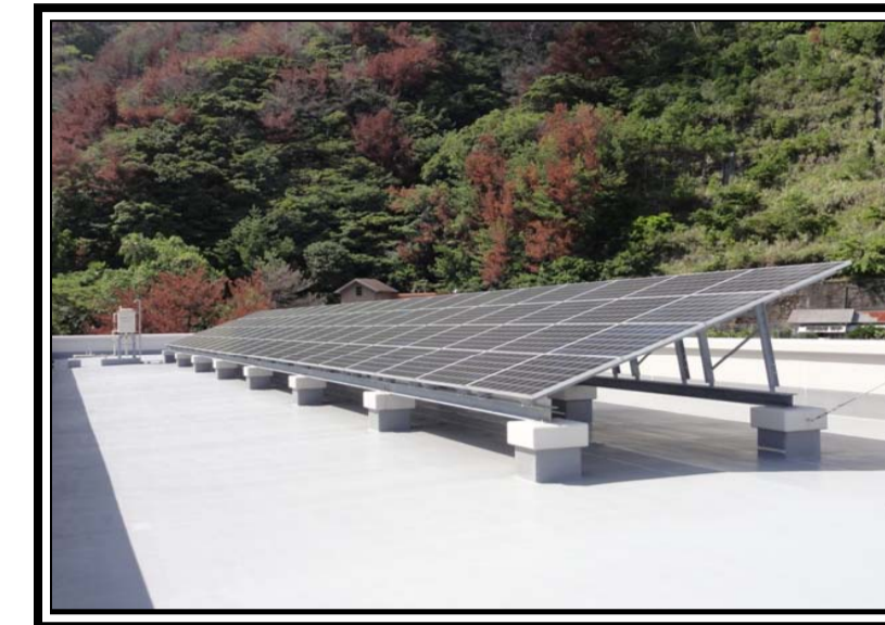
太陽光発電システム (A棟屋上)
