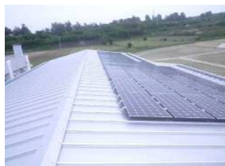
太陽光発電設備
