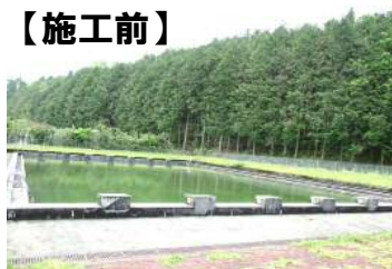
沈下により水漏れを生じていた本体(コンクリート)
