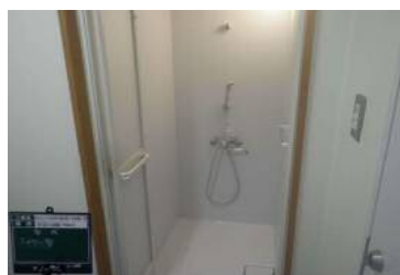
避難所指定を受け、 シャワーを完備しました
