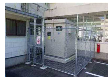
キュービクル式高圧受変電設備
