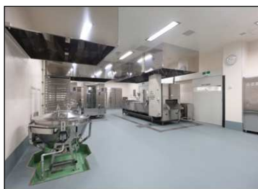
焼物・揚げ物・蒸物室
