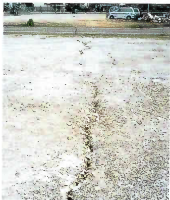
写真-3 地点Bにおける地割れ
