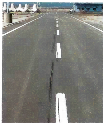
写真-2 護岸と平行な地割れ（地点A）
