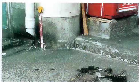
写真-7 荷捌き場前道路の沈下状況
