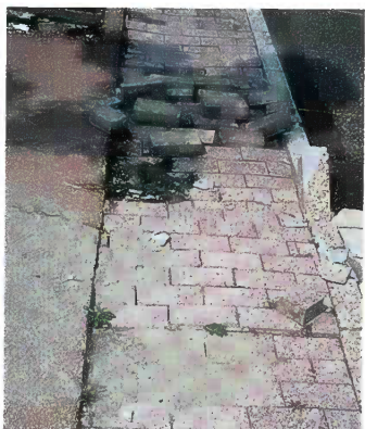
写真-5 地点Dにおける噴砂
