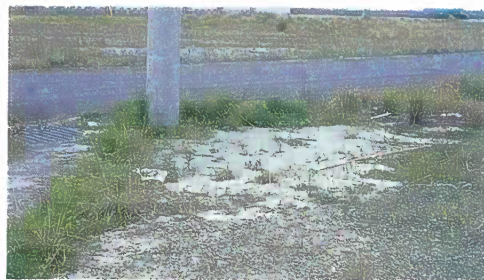
写真-4 電柱脇からの噴砂
