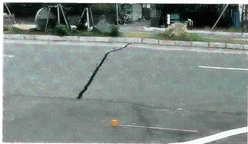
写真-1 旧護岸と埋立地の境界の地割れ
