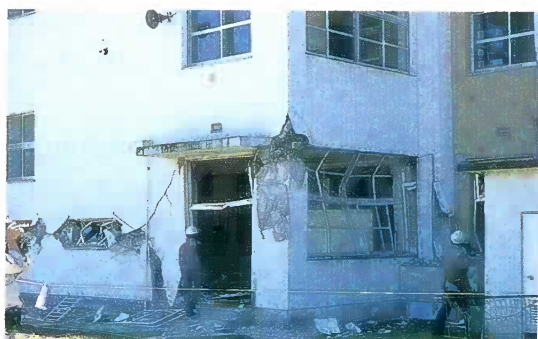
写真-16 宮之城高校特別棟の被害
