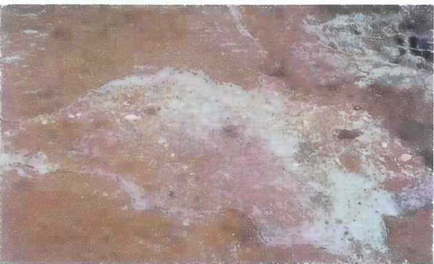
写真10 円形に噴き出した噴砂脈(鎮守尾遺跡) 内部にはローム層の破片などが詰まっている
