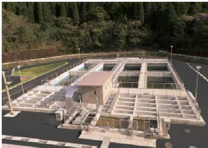
●フロック形成池・沈殿池 (管理棟から望む)
