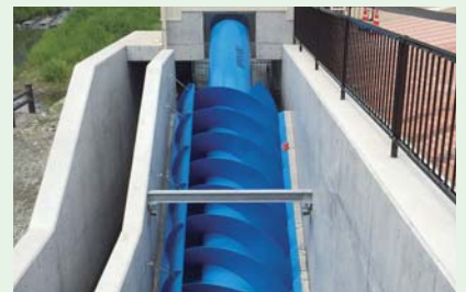
薩摩川内市の小鷹水力発電所
