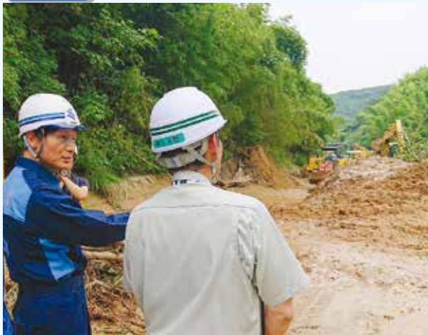
▲指宿鹿兒島インター線の中山トンネル付近の土砂災害現場
