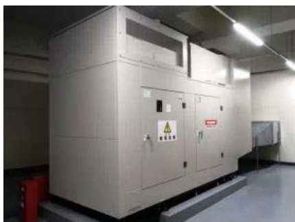
図表 5-3 非常用発電設備（八女市役所）
