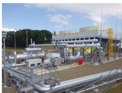
地熱発電施設(バイナリー方式)
