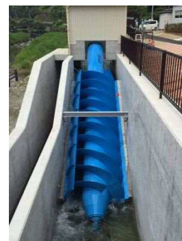
小水力発電施設
