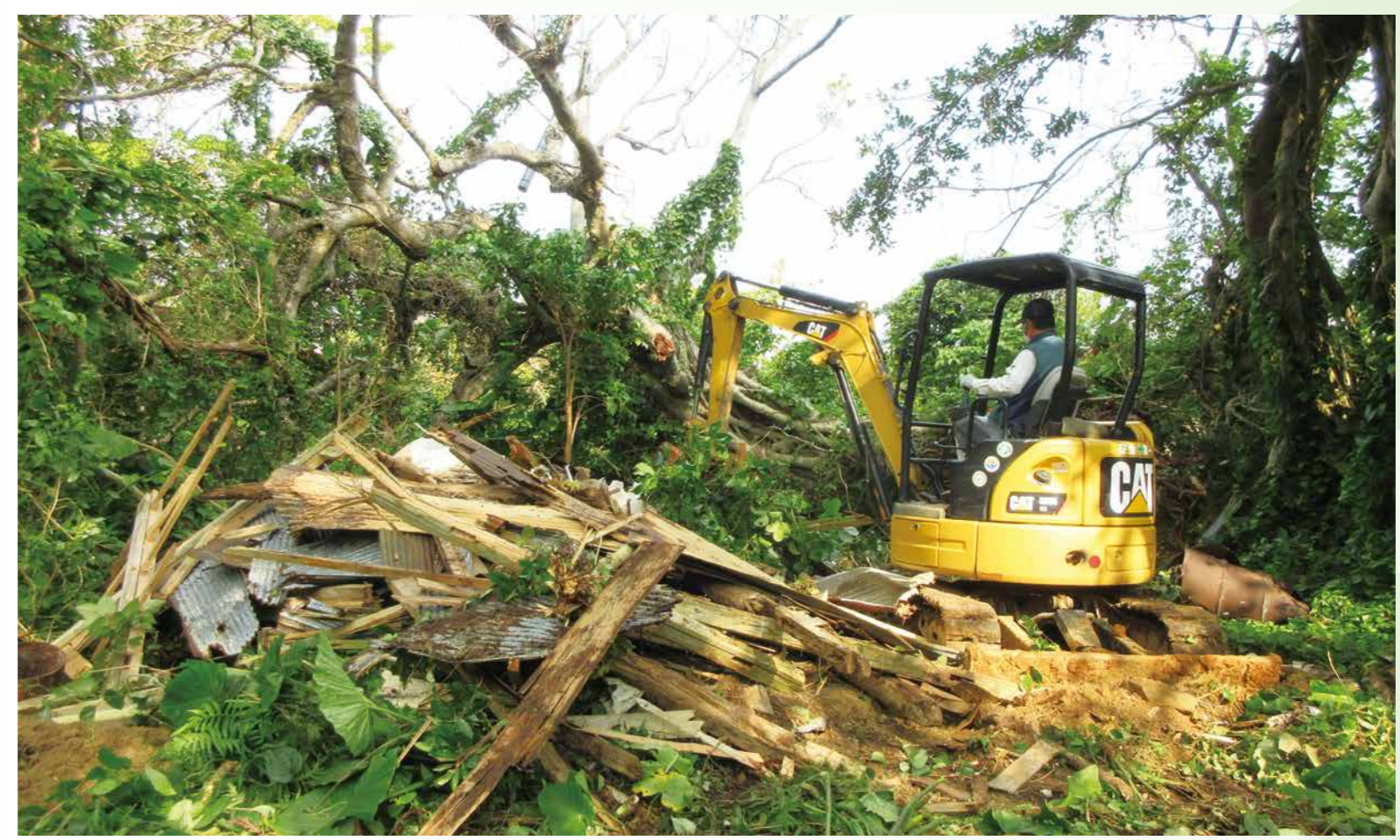
改修困難な危険家屋の解体と撤去 重機を借上げ、危険家屋の解体撤去と美化活動に取り組んでいます。
