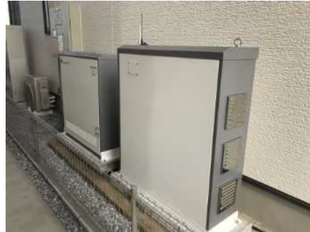
住宅に設置したDGRと蓄電池
