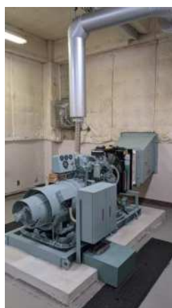
①電源局舎内の非常用発電機
