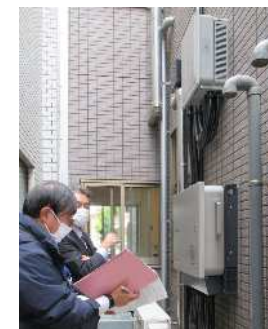
↑ 蓄電池（事務所外壁）
