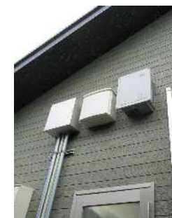
↑ パワコンの設置状況
