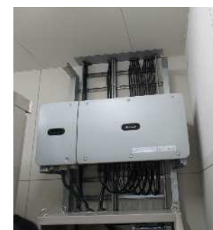
↑ パワコン（工場内）
