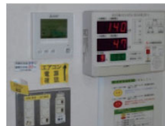
デマンド監視装置
