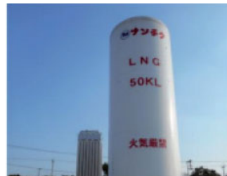
LNGサテライト
