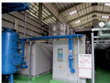
高効率冷凍機 （前工程高効率化により小型化）
