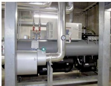
ターボ冷凍機の導入 (平成27年度経産省補助金)
