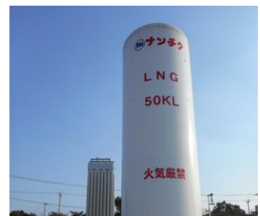
LNG サテライト
