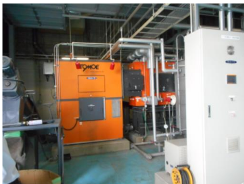
【木質バイオマスチップボイラー】
