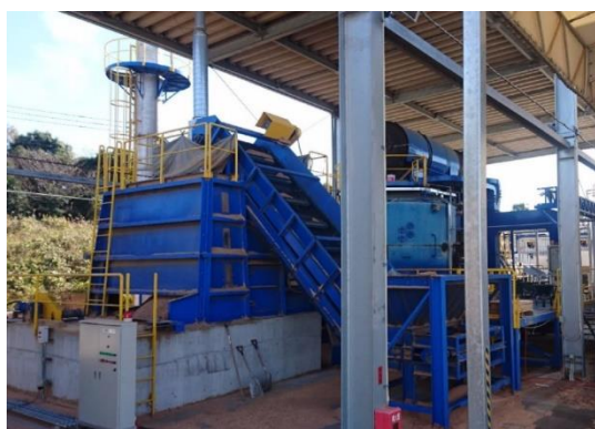
【木質バイオマスボイラー】
