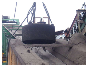
リターンベルトでマグネットによる金属除去
