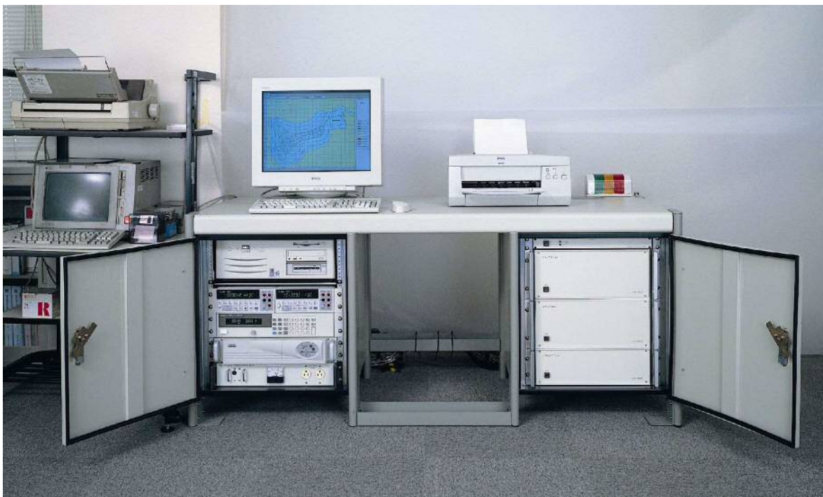
写真4 漏水検知システムの管理設備の例
