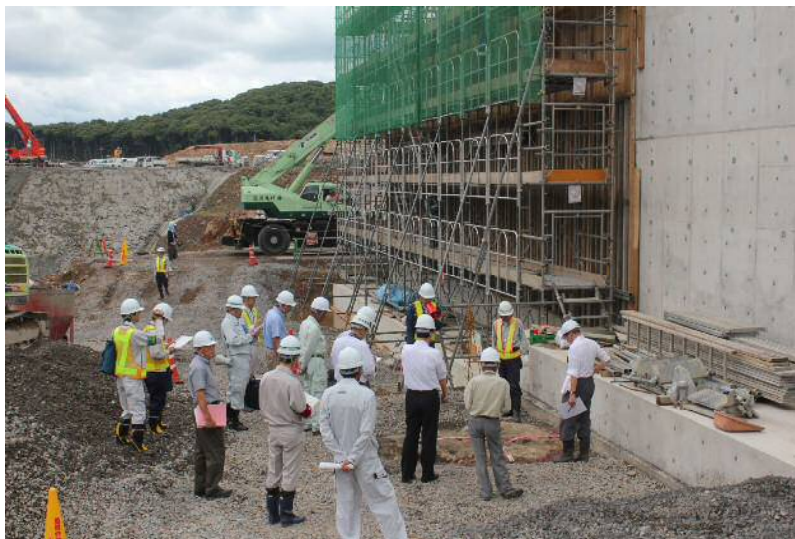
浸出水処理施設
