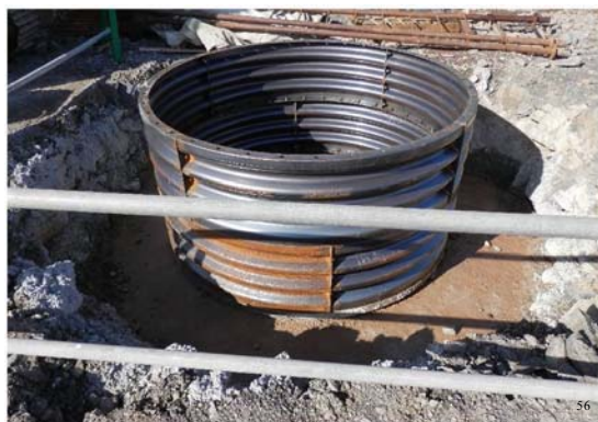
地下水放流管・人孔
