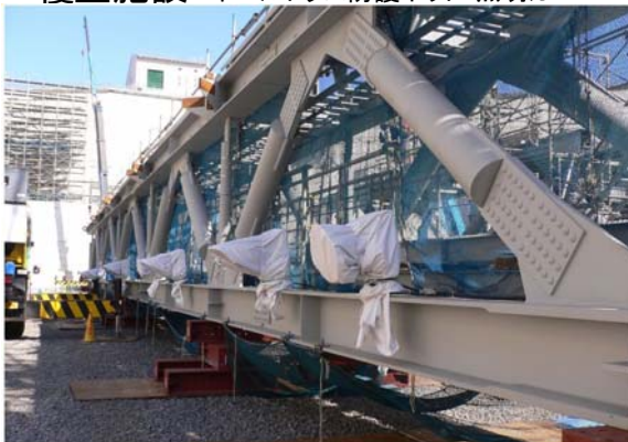
覆蓋施設・キールトラス防護ネット・照明カバー
