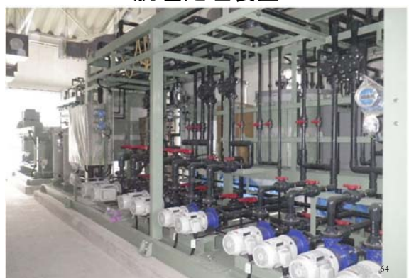
脱塩処理装置
