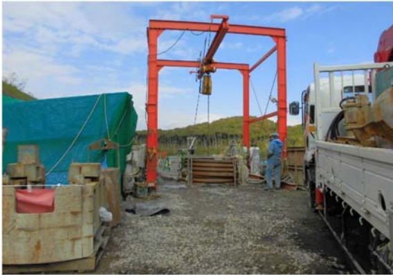
地下水放流管・人孔(№1)
