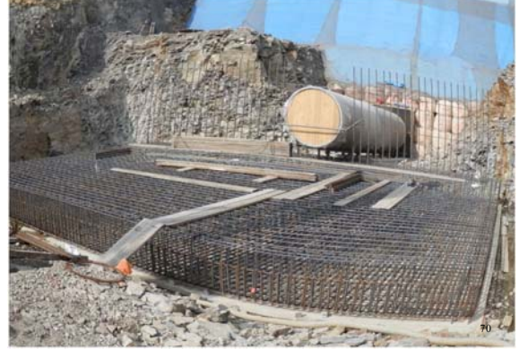
防災調整池・放流管及び放流塔底盤
