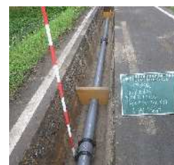
パイプライン
