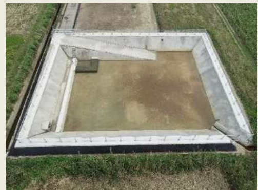
耕土流出防止のための沈砂池
