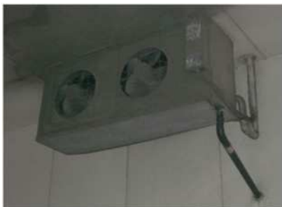
図2 空調設備の管理（提供：埼玉県）
